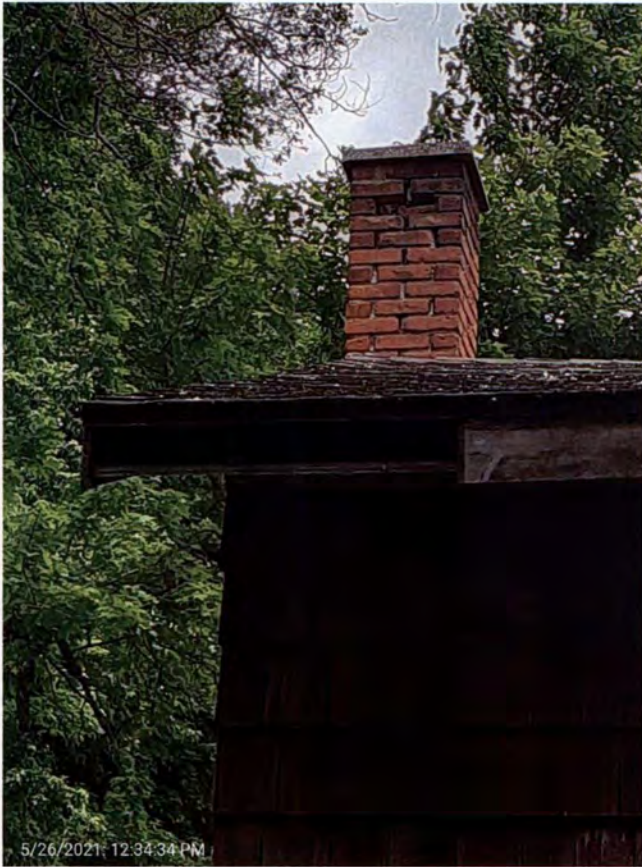
Deteriorating fascia/ chimney
